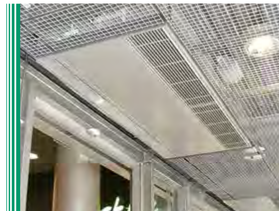
VENTILACIÓN ROOF TOP
